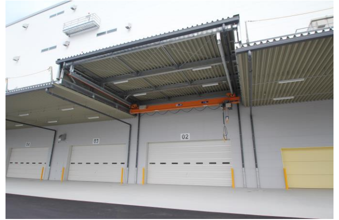
大庇と天井クレーン
